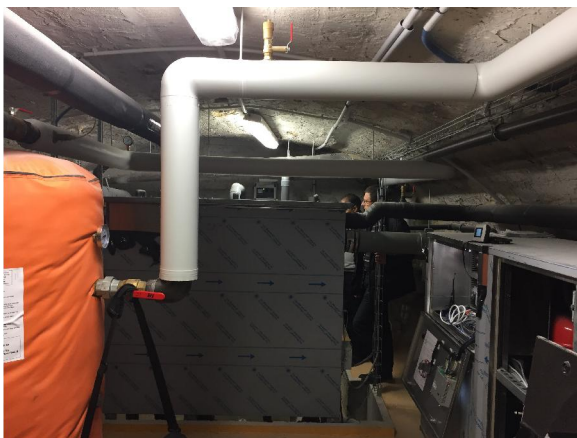
ERS Biofluides en cours de mise en route
